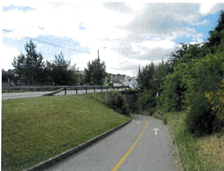
Figur 9. Undergangen ved Linnegrøvan er smal og har svært dårlig sikt (SVV).
