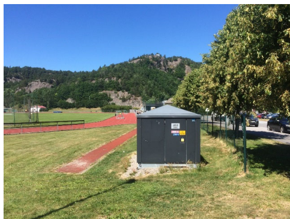
Figur 71: Trafostasjon mot sørøst
