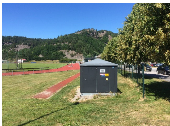
Figur 30: Trafostasjon mot sørøst
