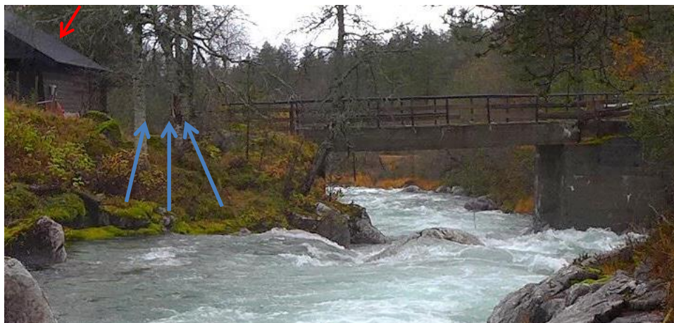
Figur 15 Bilete viser brua og mest naturlege vassveg (blå piler) ved oppstuvning av is under brua. Raud pil viser eksisterande garasje på B2.
