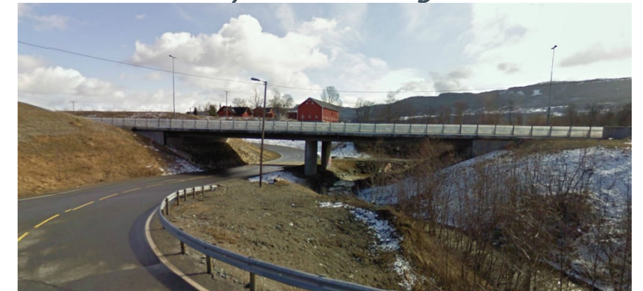
På E6 Røskaft – Skjerdingsstad brukes bruer på Eidsmo og på Kvål for å ivareta kryssing for bekk, fotgjenger og dyr og driftsveg under E6. De nye E6-bruene utformes tilsvarende den eksisterende E6-brua ved Brubakken på Melhus. Terrenget rundt landkar, bekkedal og bekk er formet som en naturlig del av omgivelsene og kantskogen bidrar til å binde alt sammen. (Foto: Google.maps.no)
