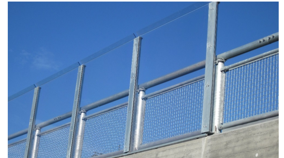
Det må være støyskjermer på Røskaftbrua og Kåsabrua. Skjermene er 2 m høye, transparente og med utforming som vist på bildet. (Foto Bjørnar A. Larsen)
