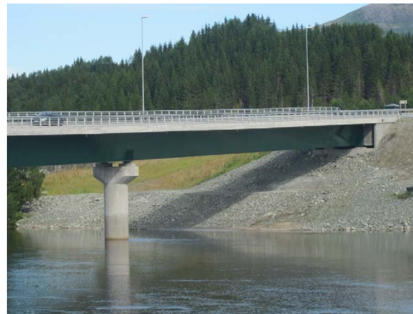
Brupilarene utformes slik som brua i Harran. Men brua her er tung og lav. Terrenget rundt landkarene formes slik at landskapsformen i området beholdes og at bruene ligger lett i landskapet slik at det blir rom under brua og en passasje langs elva. Foto: Bjørnar A. Larsen
