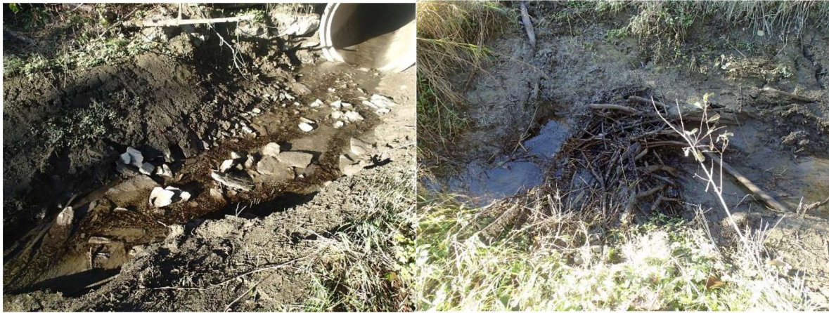
Figur 3-5 Bildet til venstre viser området rett oppstrøms kulvert under E39. Bildet til høyre viser typisk vandringshinder som har oppstått på strekningen.
