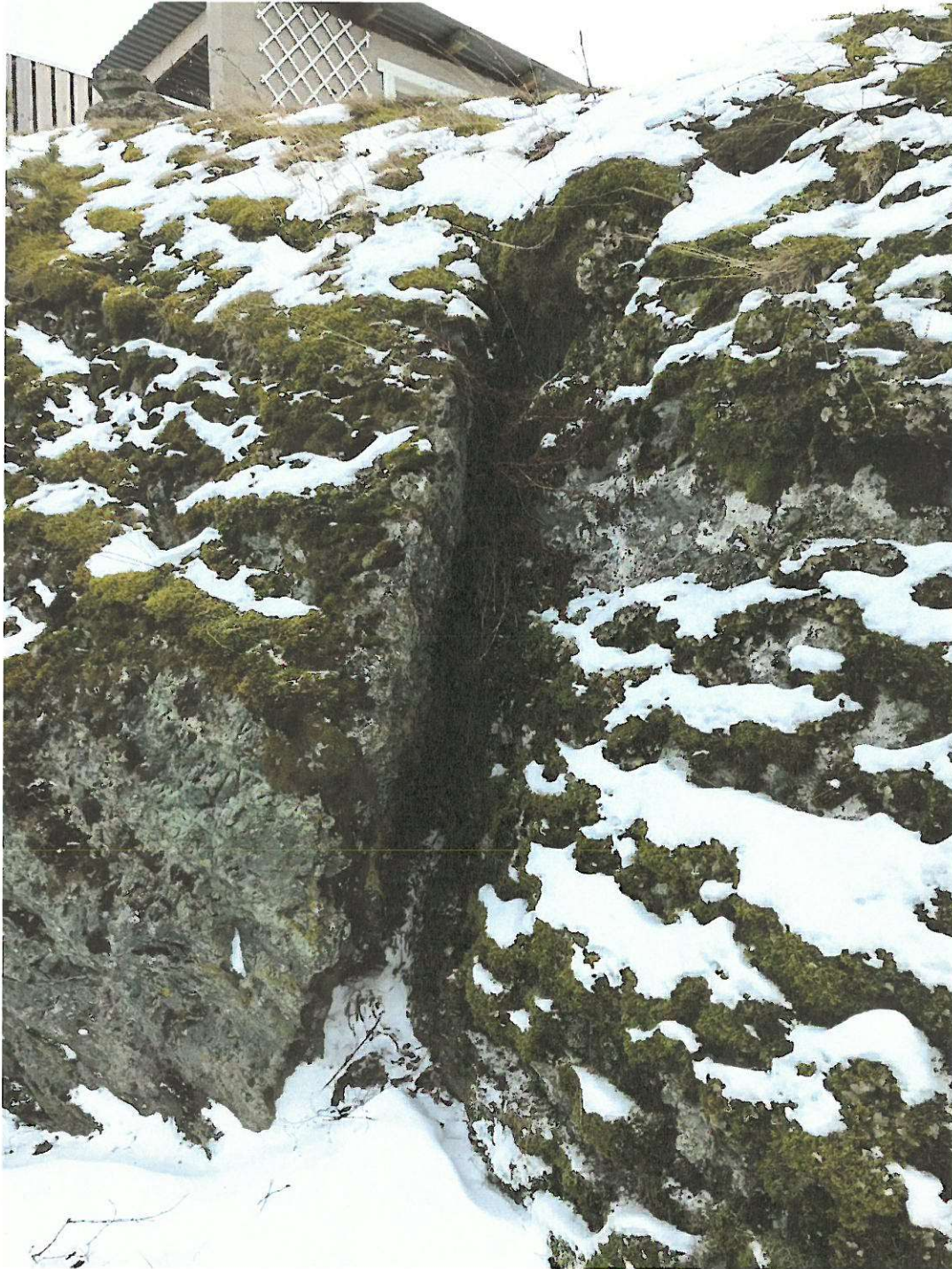
Bilde 15. En sprekke i bergkant på nordvestlig del. Bildet mot øst.
