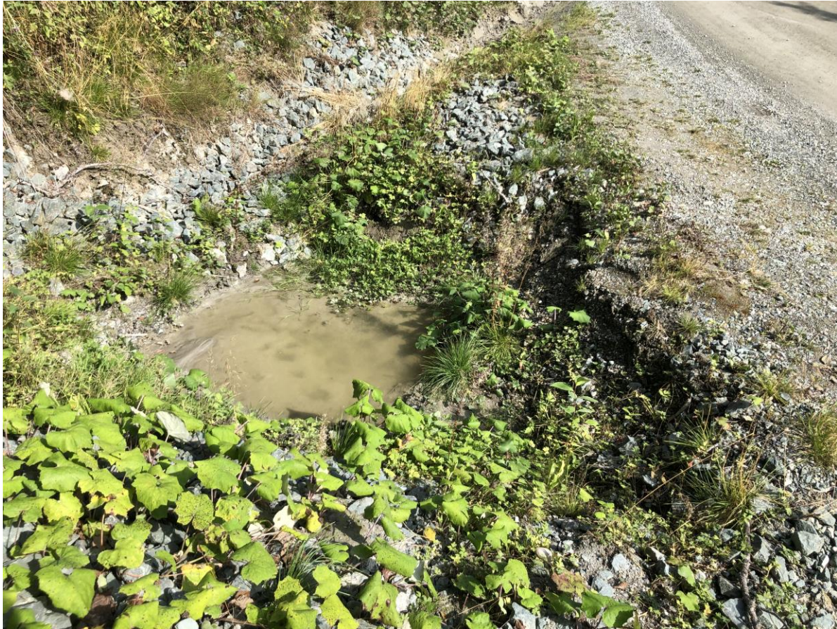
Bilde 10. Tilslammet inntak for stikkrenne gjennom Kregnesveien
