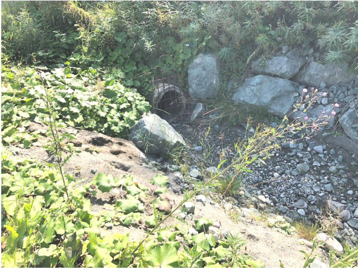
Bilde 2a. Inntak til rør Ø400 for bekken
