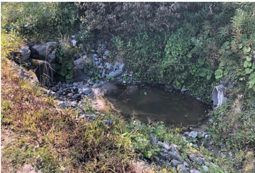
Bilde 2. Åpen slamgrop i bekken inn til kulvert Ø800
