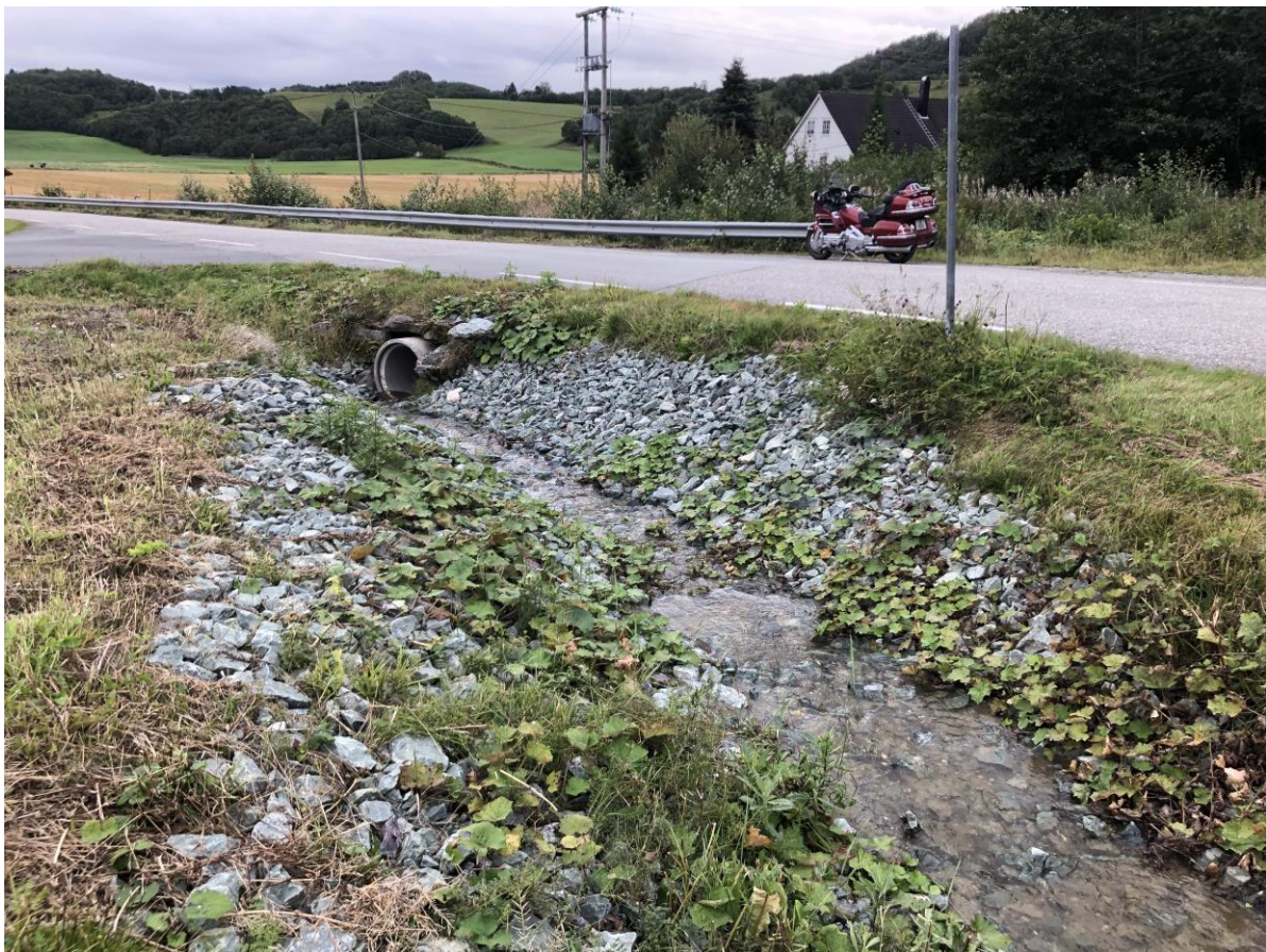
Bilde 22. Inntak stikkrenne Ø800 på fylkesvegen
