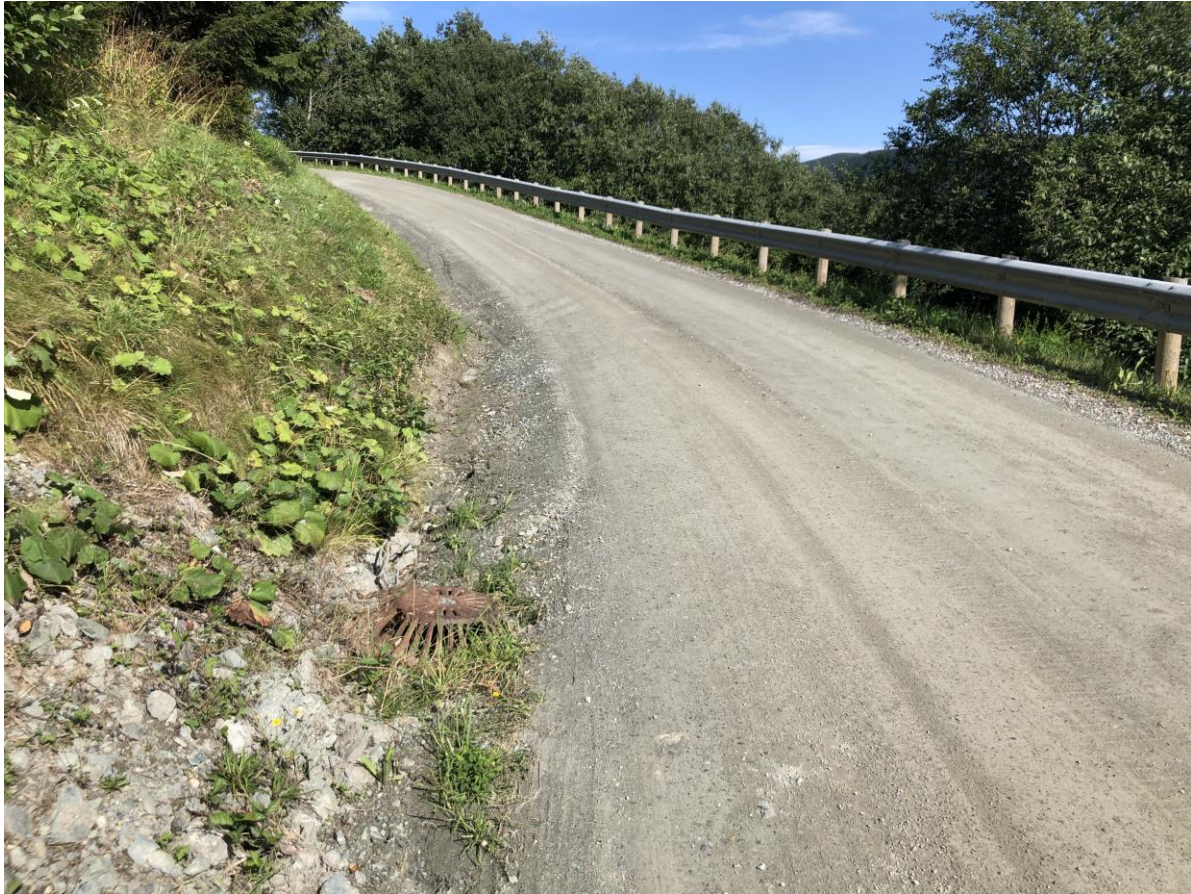
Bilde 14. Grunt sandfang ved innløp stikkrenne Ø150 gjennom Kregnesveien
