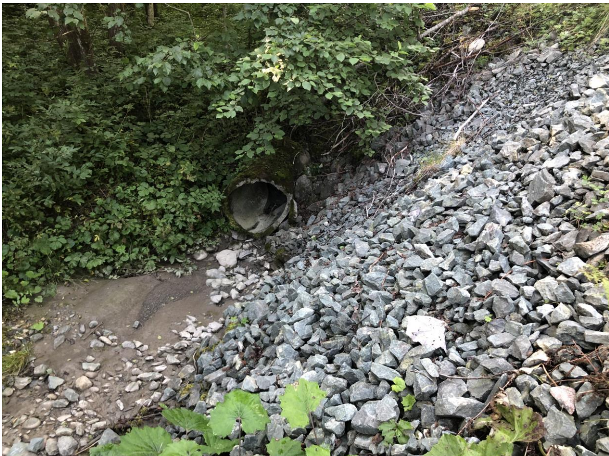
Bilde 5. Utløp kulvert Ø600 for bekk langs sørsiden av Kregnesveien
